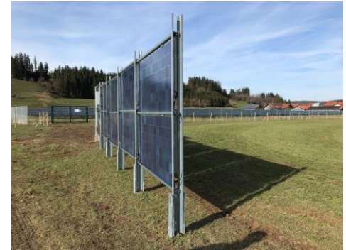
Testanlage in Biessenhofen
