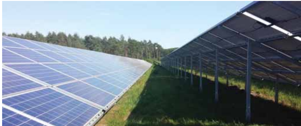
Abbildung 1-7: Reihenabstand von ca. 2,5 Metern in einer PVA nördlich des Flugplatzes Neuhardenberg (BB). Von der Sonne beschienene Fläche ca. 0,8 m Breite
