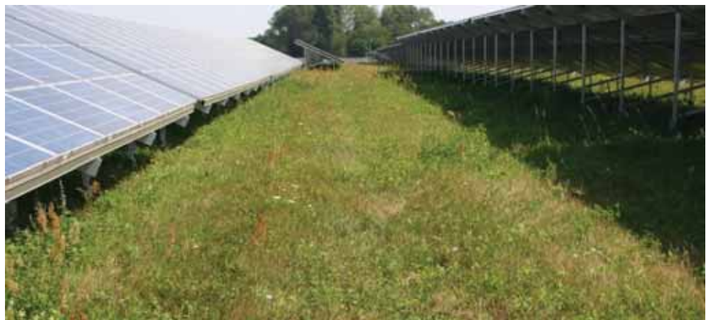
Abbildung 1-6: Reihenabstand von ca. 6 Metern in einer PVA nördlich des Flugplatzes Werneuchen (BB). Von der Sonne beschienene Fläche ca. 4 - 4,5 m Breite
